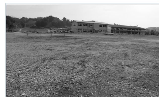
旧緒方工業高校跡地の整備活用のため、旧緒方工業高校体育館の解体工事が行われました。
