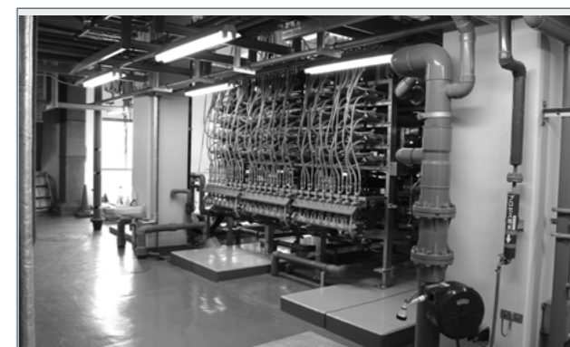
施設の経年劣化が進んでいた白鹿浄化センター設備の大規模な改修が実施されました。
