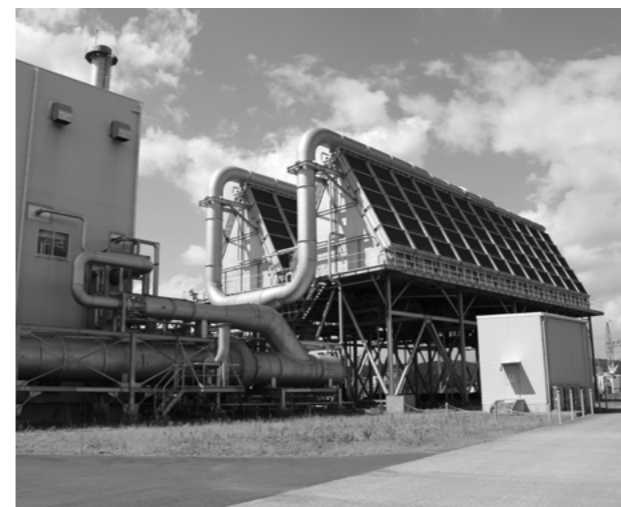
木質バイオマス発電所（エフオン豊後大野）
