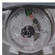
× 指示圧力計の損傷
