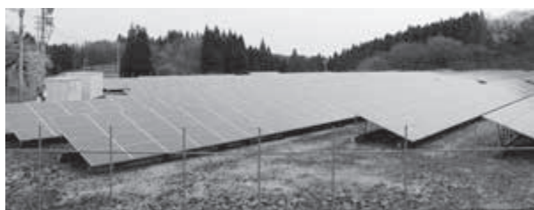
豊後大野市太陽光第1発電所
