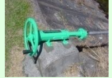
ゲート、バルブの更新
