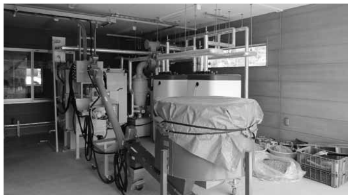
バイオマスボイラー
