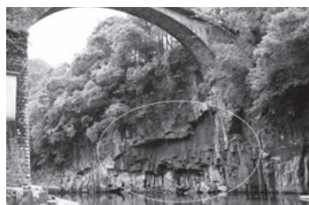
轟橋下方の崩落後
