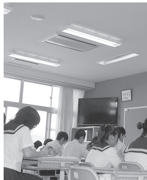
教室に設置しているエアコン（犬飼中学校）
