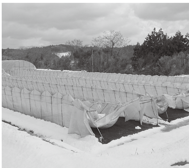
雪で倒壊したビニールハウス
