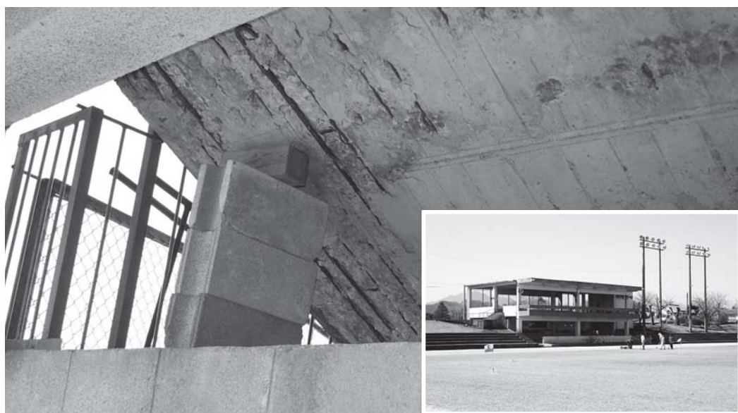
露出したさびた鉄筋
