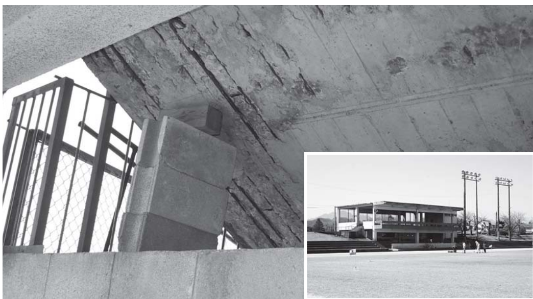
露出したさびた鉄筋
