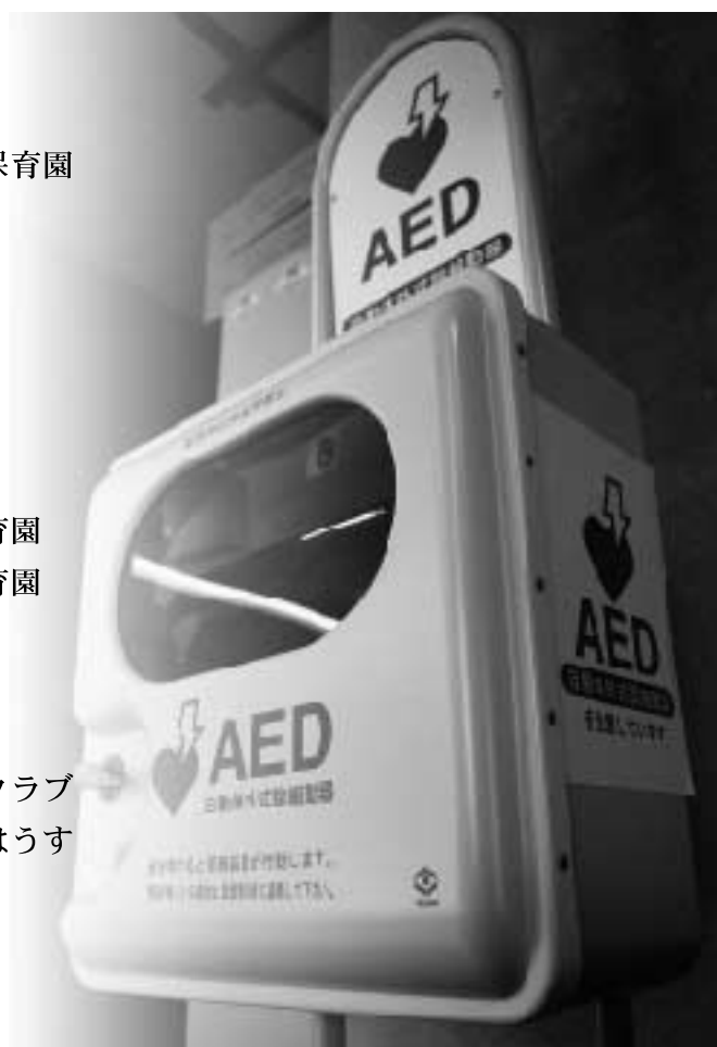
設置された自動体外式除細動器 (AED)
