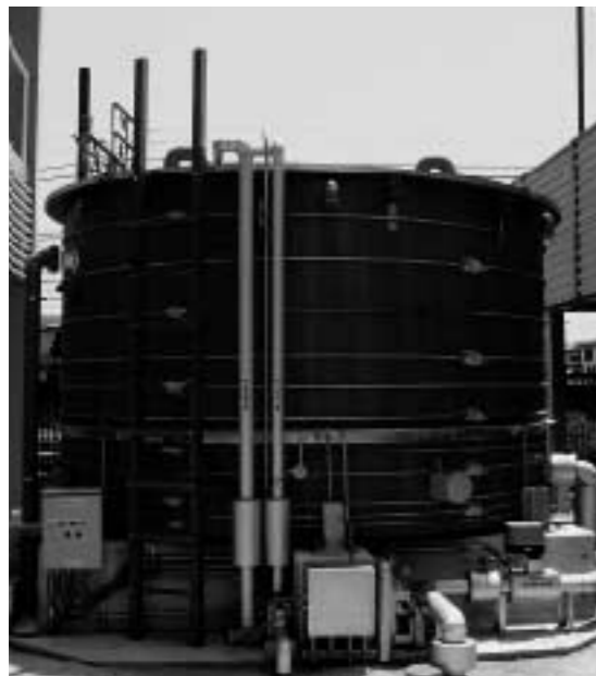
雨水再利用の貯留タンク（愛知県犬山市役所）
