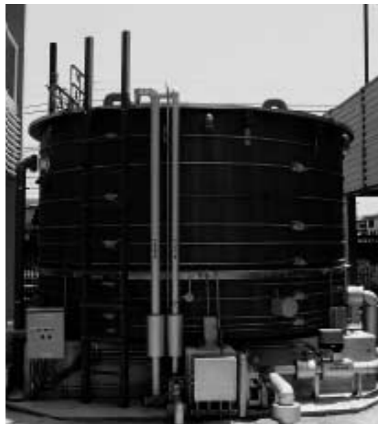
雨水再利用の貯留タンク（愛知県犬山市役所）
