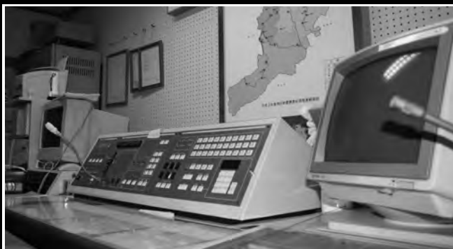
本庁2階にある防災無線室
