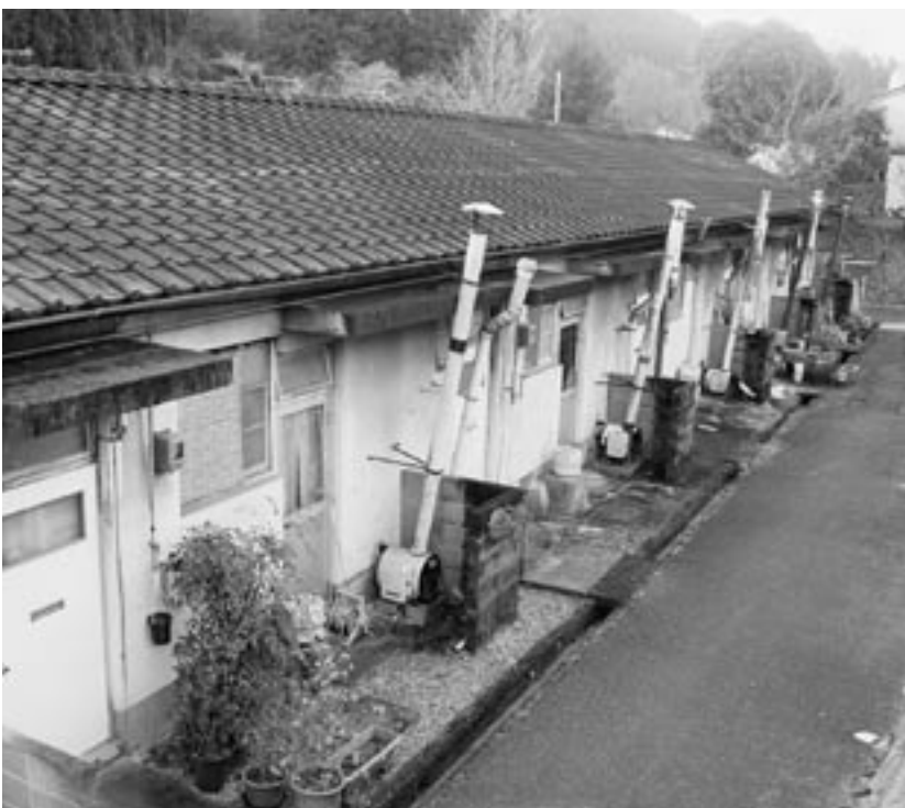
老朽化が著しい市営住宅（朝地町）
