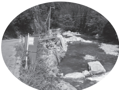
増水でえぐられた道路・河川 （緒方町上畑） うわはた
