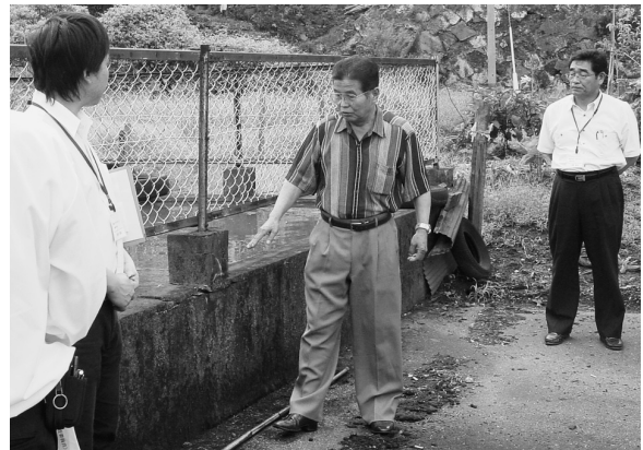
老化の進んだ防火水槽（清川町砂田）
