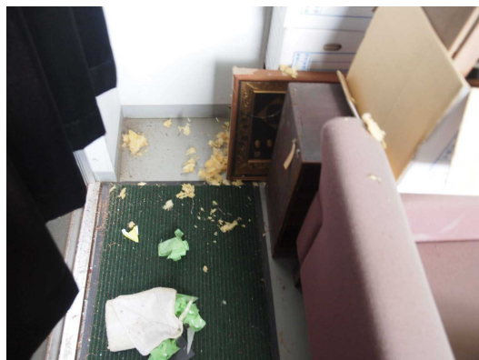
旧緒方公民館小動物の侵入痕跡
