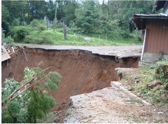
写真7 崩落した県道7号線
