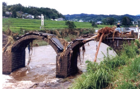
写真 2 被災した鳴滝橋
