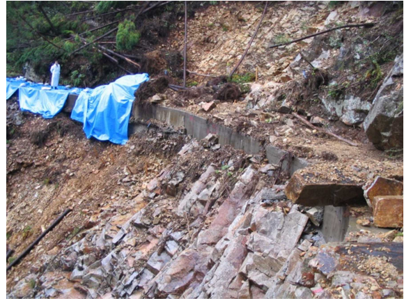
写真6 長谷緒井路の被災
