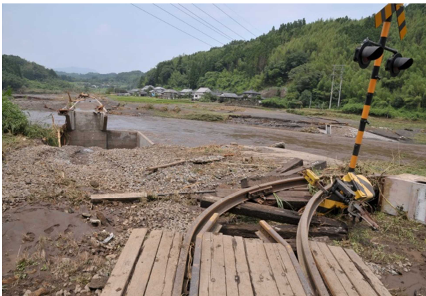
写真9 流失した第一大野川橋梁
