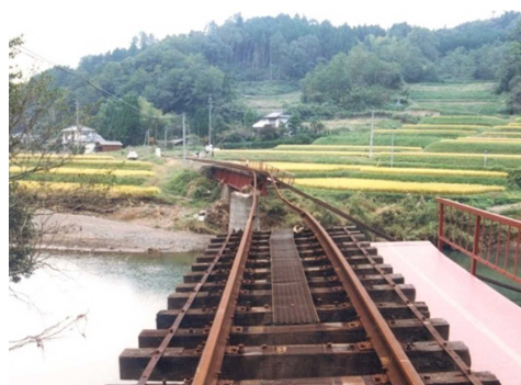
写真 4 流失した緒方川橋梁(野尻)
