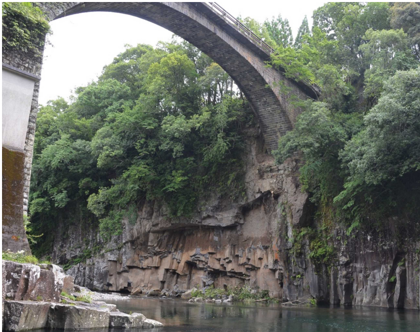
写真 33 2016年熊本地震による轟橋直下の岩壁の崩落状況
