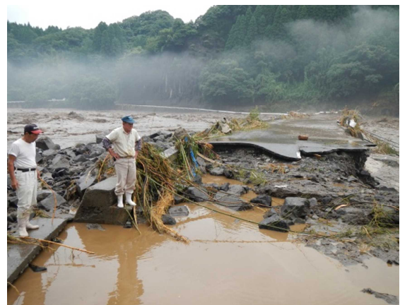
写真10 損壊した猿飛橋
