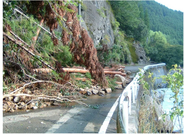
写真8 崩落した県道7号線
