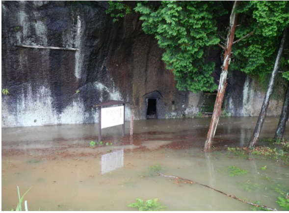
写真 13 冠水した辻河原石風呂
