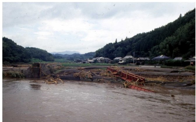
写真1 流失した第一大野川橋梁
